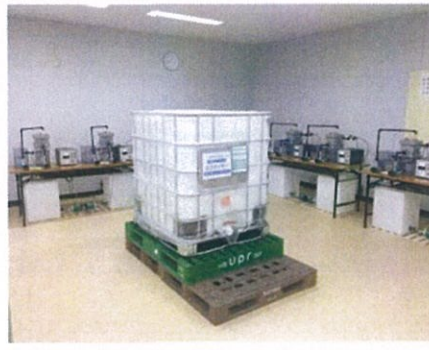
10 台の電解電子機能水生成装置が設置され、1日20トンの電解電子機能水「ECOMIZER」が生成されます。(国内最大規模です。)
